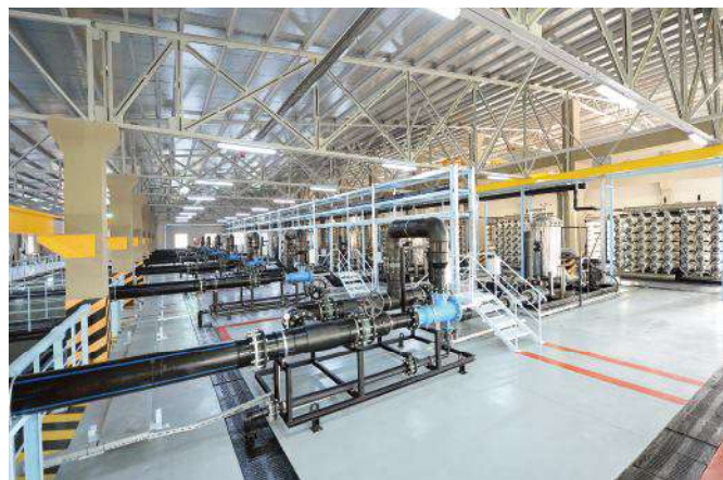
Naxçıvan şəhərinin sutəmizləyici qurğular kompleksi
