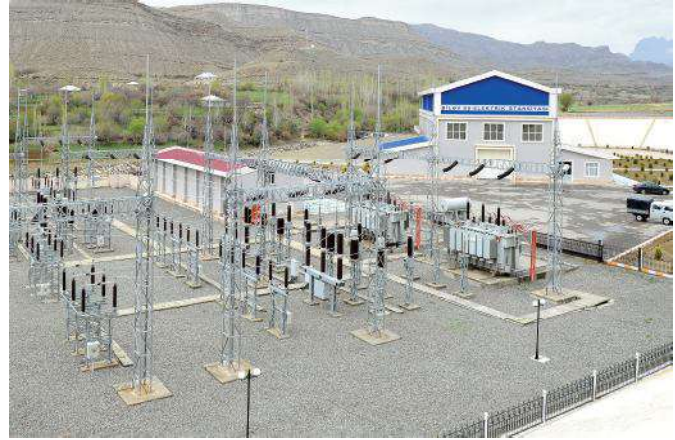
Biləv Su Elektrik Stansiyası
